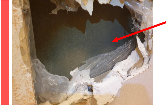
Figur 13 Denne typen vindsperreplater observert i Blokk 2 inneholder erfaringsmessig asbest.
