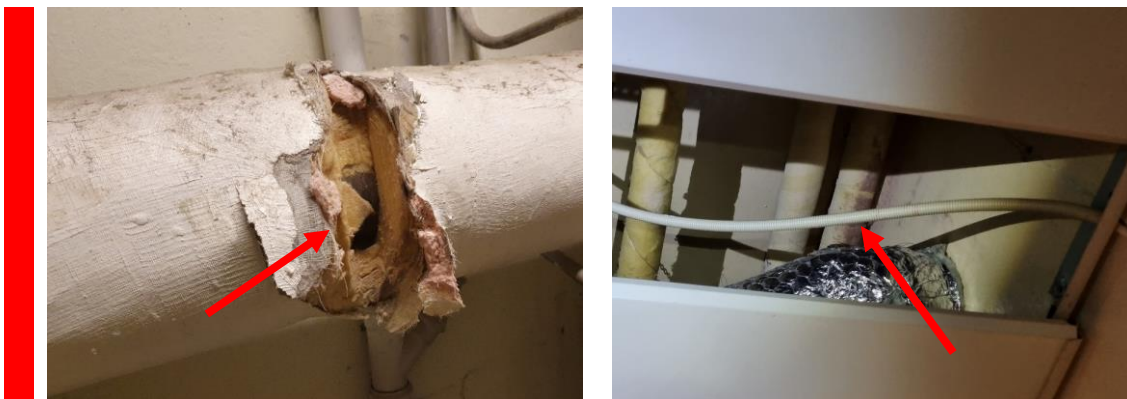
Figur 40 Rørisolasjon med mistanke om asbest. Fyrrom kjeller (t.v) og i himling (t.h)
