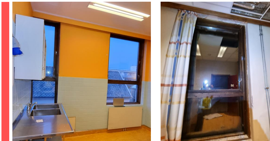
Figur 48 Isolerglassruter i bygget fra 1977 inneholder erfaringsmessig klorparafiner.
