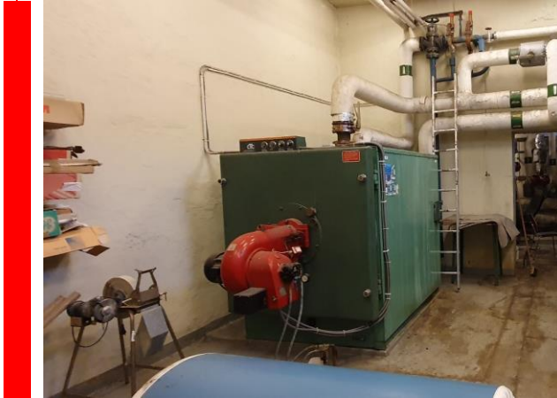
Figur 44 Eldre fyrkjel i kjelleren Blokk 1.
