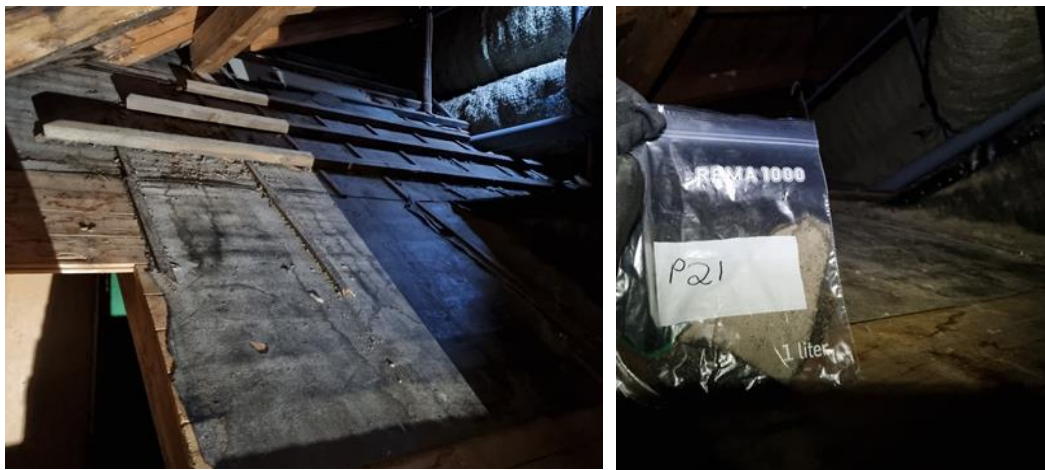
Figur 51 Prøve (P21) tatt av takpapp på loftsetasje i Blokk 1, det ble ikke påvist PAH verdier over grenseverdien for farlig avfall.
