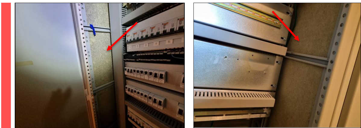
Figur 17 Asbestplater i sikringsskap.
