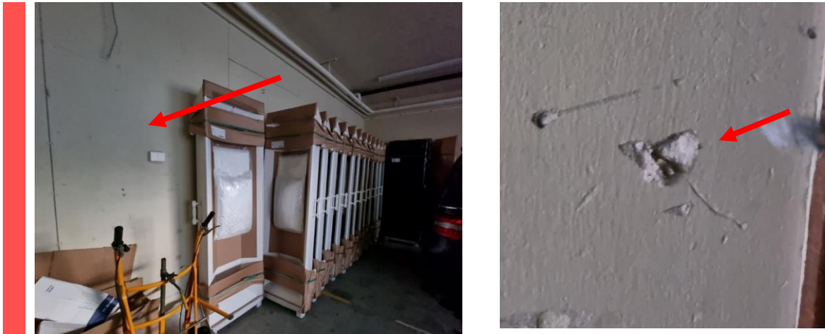
Figur 15 Veggpanel med mistanke om asbest i garasje i underetasje i Blokk 2.
