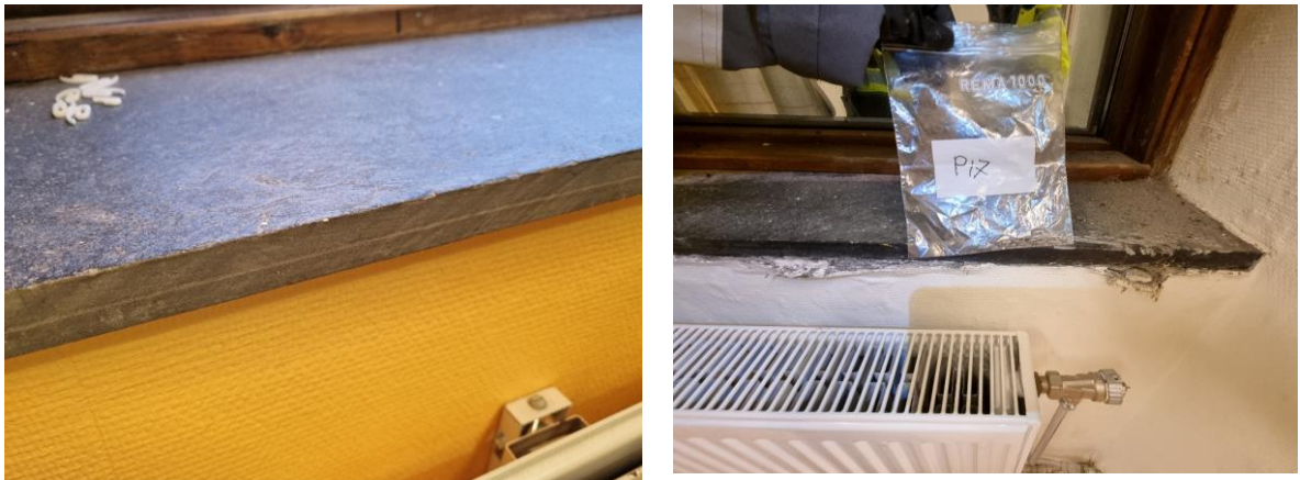
Figur 22 Bildet viser eksempel vindusbrett med mistanke om asbest i Blokk 1. Det ble tatt en prøve P17 som ble analysert for innhold av asbest. Prøvene viste ikke innhold av asbest.
