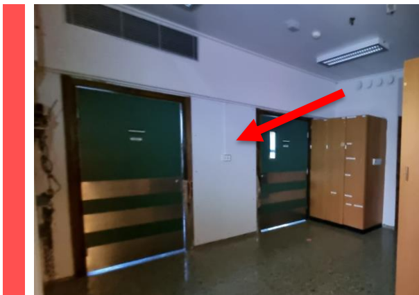
Figur 16 Veggpanel med mistanke om asbest i tredje etasje Blokk 1.
