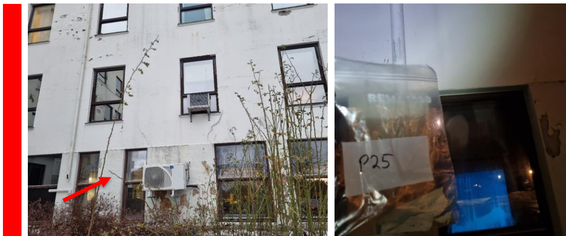
Figur 46 Prøve (P25) av malingen på fasaden inneholder sink over grensen for farlig avfall.
