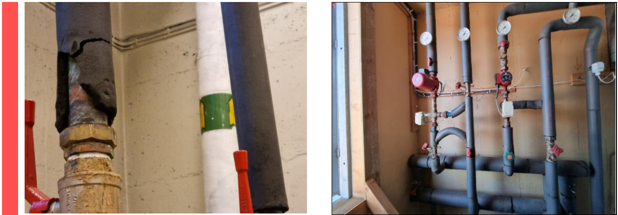
Figur 62 Cellegummi på rør i fyrrom Blokk 1 og teknisk rom Blokk 2
