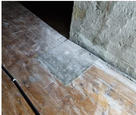
Figur 33 Eksempel på forekomster av mulig asbestholdig belegg. På gulv ved feieluke på loft i bygg 1.
