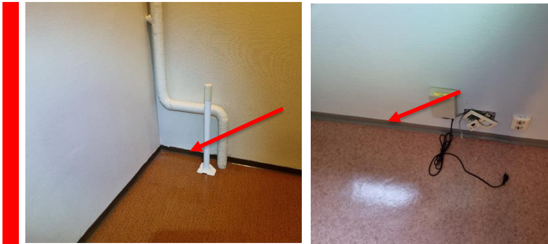
Figur 55 Vinylister er gjennomgående observert i hele bygget.
