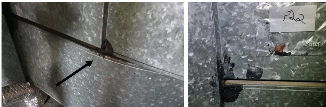
Figur 42 Ventilasjonskanal i teknisk rom Blokk 1 med svart fugemasse i skjøtene. Prøven viser ikke innhold av asbest.
