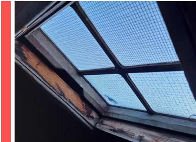
Figur 21 Viser eksempel på vindu som kan inneholde asbest.
