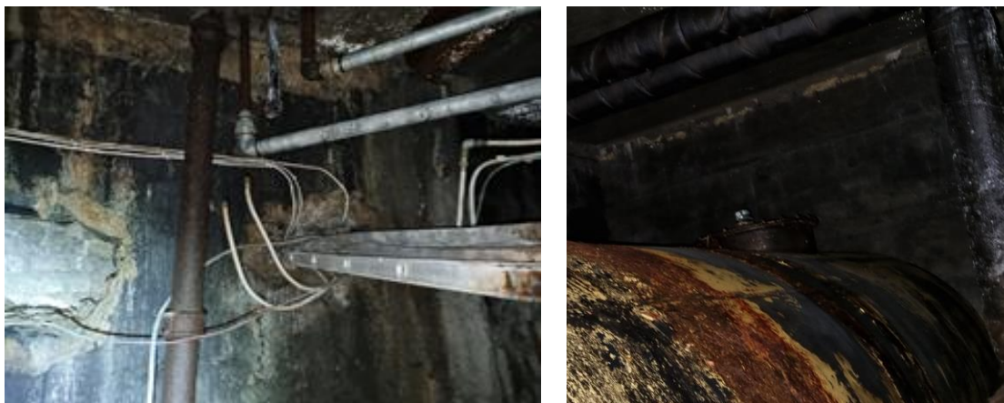
Figur 61 Det er registrert avsetninger av oljesøl på betongvegger ved oljetanker.
