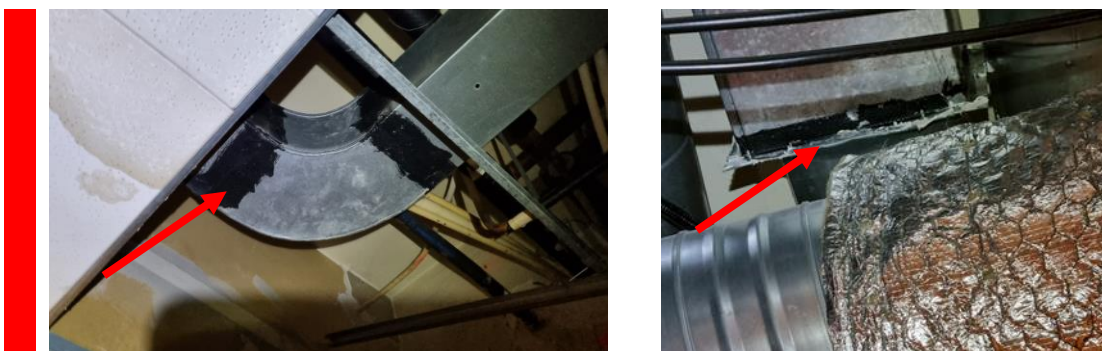
Figur 43 Ventilasjonskanal bak himling med fugemasse i skjøtene.
