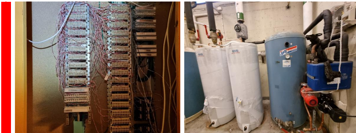
Figur 67 Eksempler på EE-avfall i bygget.
