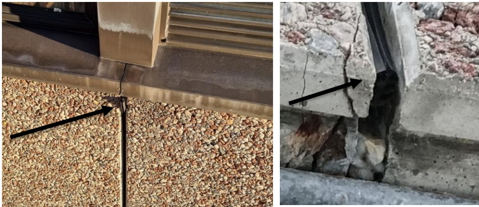
Figur 47 Tettelist mellom fasadeplater på Blokk 2.
