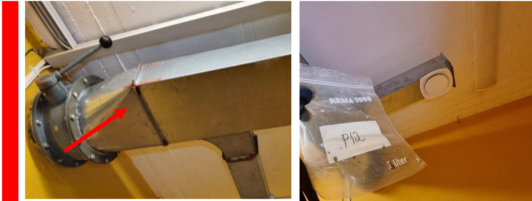
Figur 41 Ventilasjonskanal i tilfluktsrom i Blokk 2 med svart/rød fugemasse i skjøtene. Det ble påvist innhold av asbest
