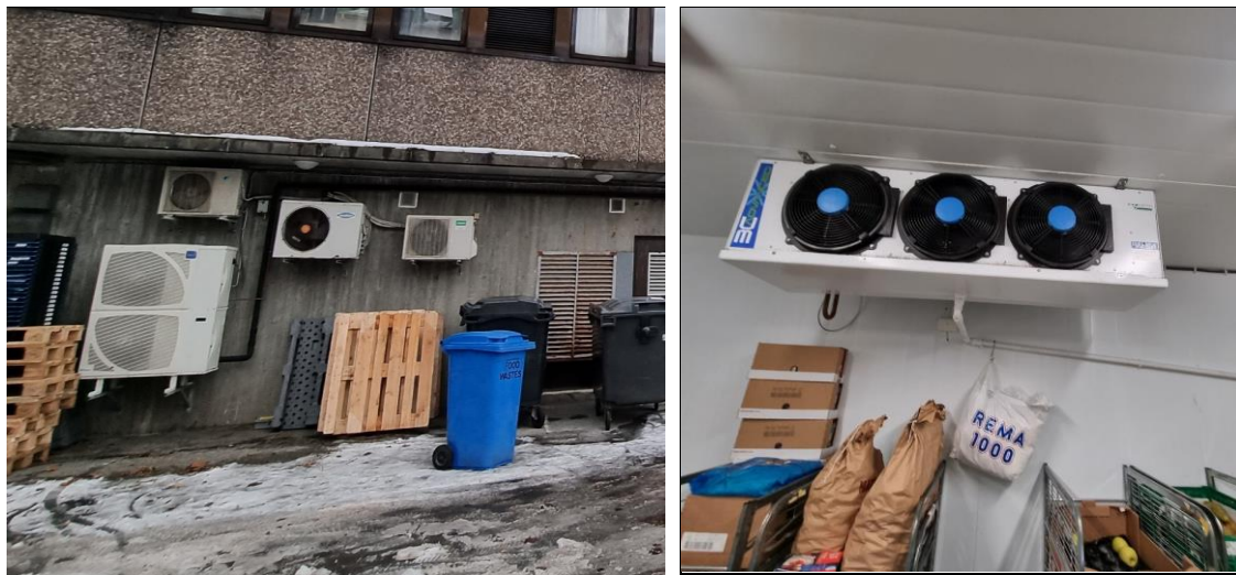
Figur 69 Kjølemaskiner på fasade mot vest, Friga-Bohn kjølemaskinen i lageret i underetasjen
