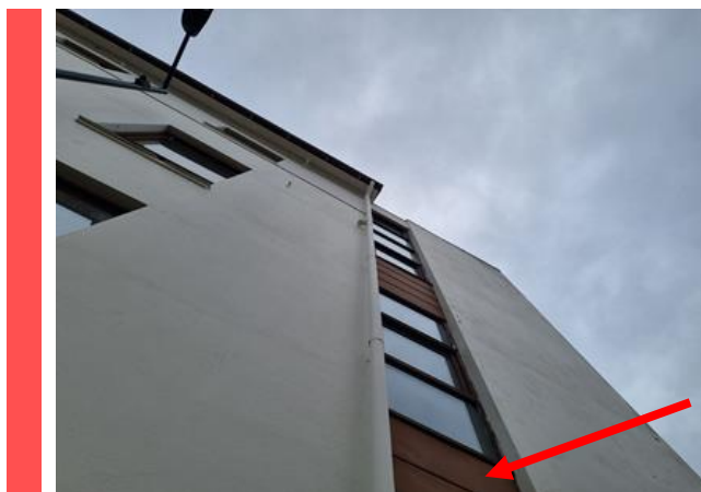
Figur 18 Utvendige plater med mistanke om asbest i trappeoppgang i Blokk 1.
